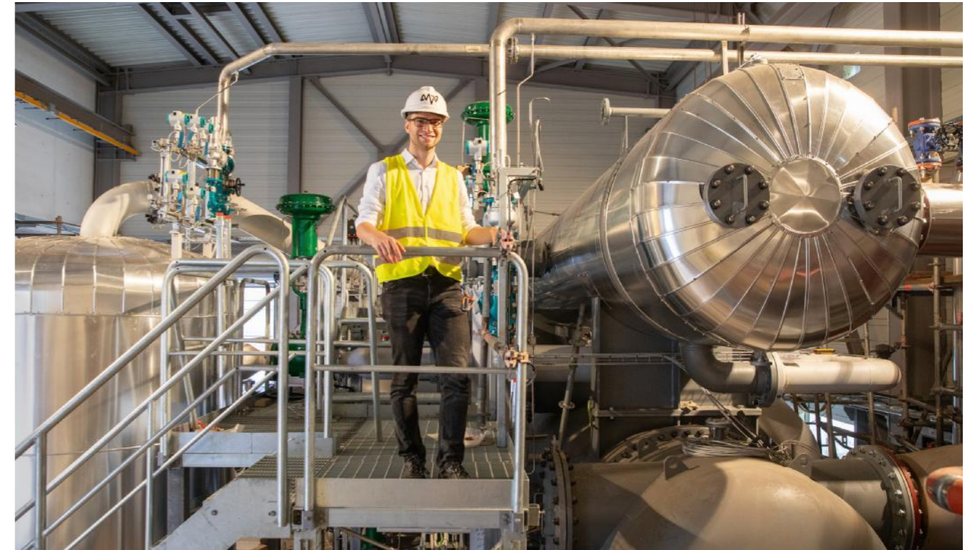
Die neue Flusswärmepumpe auf dem Gelände des Grosskraftwerks Mannheim. Felix Hack leitet das Projekt
