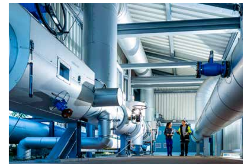
Unsere Fernwärme wird direkt in Mannheim durch hocheffiziente Kraft-Wärme-Kopplung erzeugt. Wasser wird erhitzt und durch ein isoliertes Netz aus Fernwärmerohren zum Kunden transportiert
