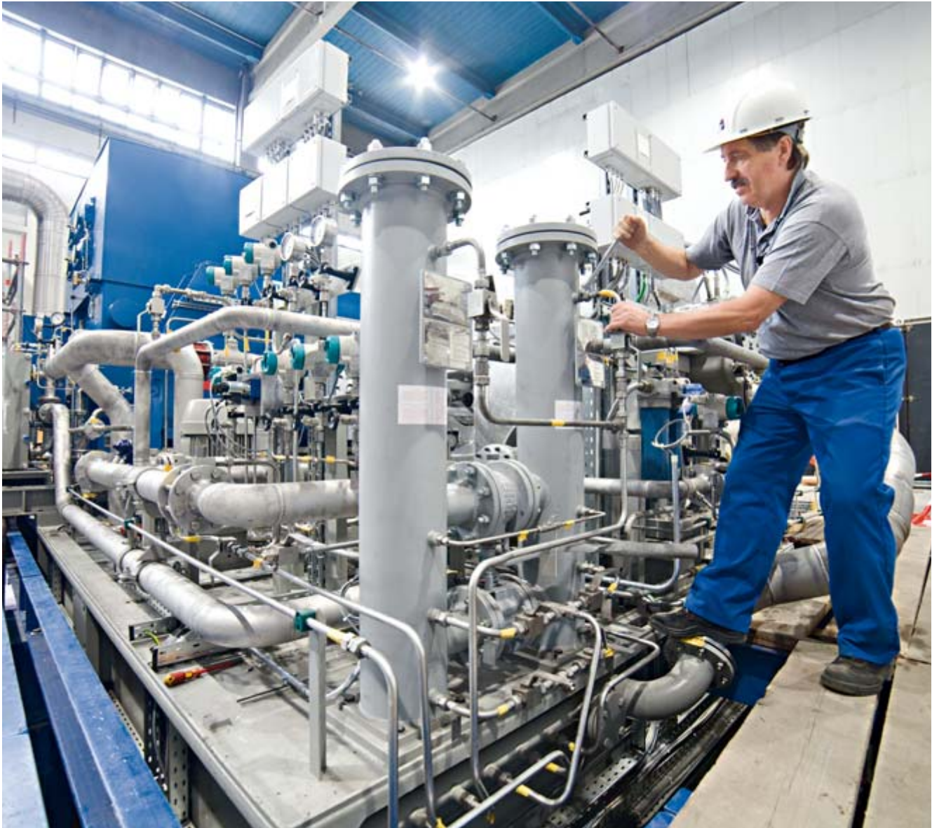
• Eine der beiden Gegendruck-Dampfturbinen (hier Turbine D0) im Projekt OptiMa kurz vor dem Probebetrieb
